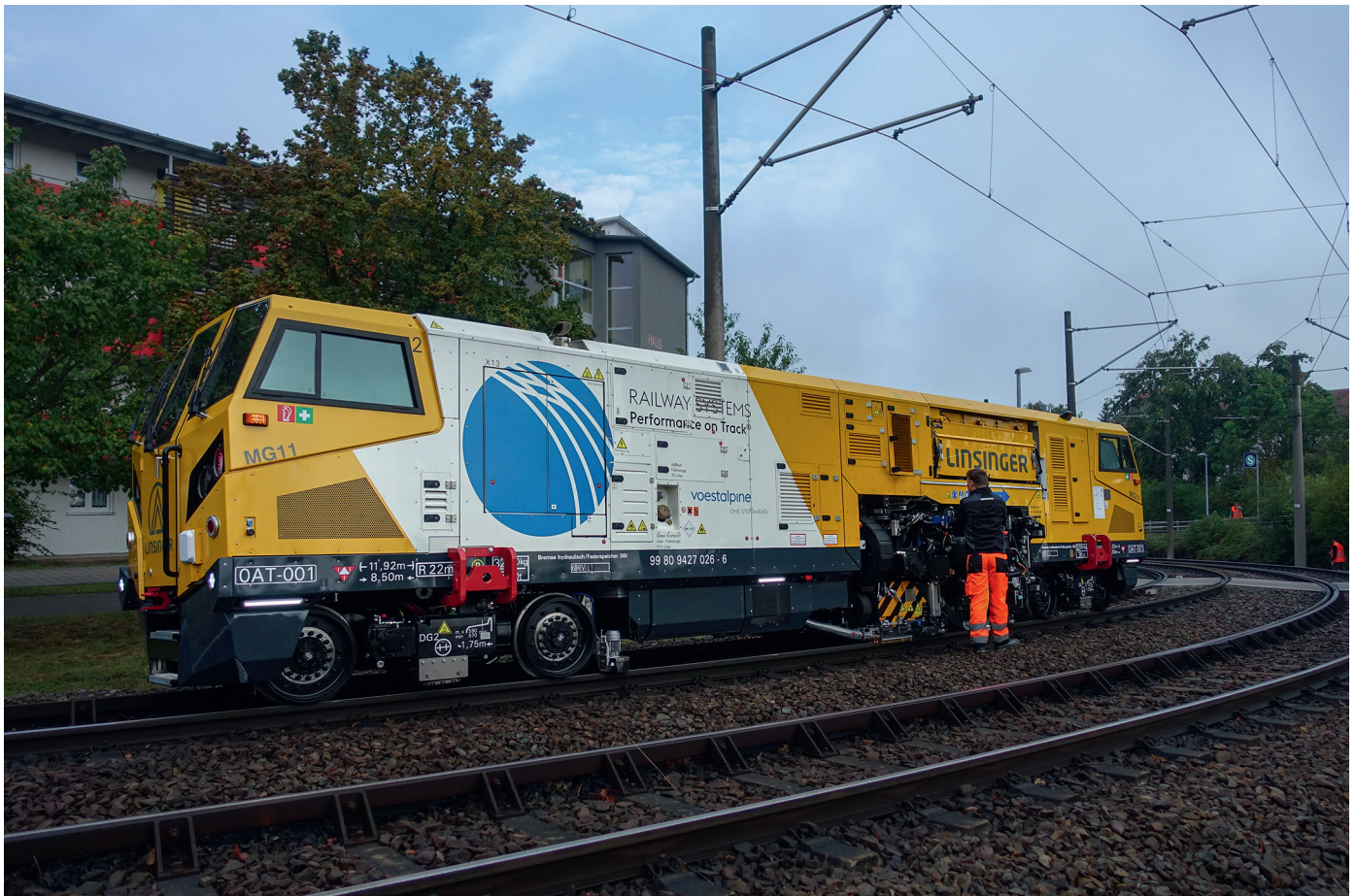
Abb. 4: Fräsarbeiten in einem engen Bogen ( R < 100\text{ m} ) bei AVG. Die dazugehörigen Schienenprofilmessungen sind in Abb. 3 dargestellt.
